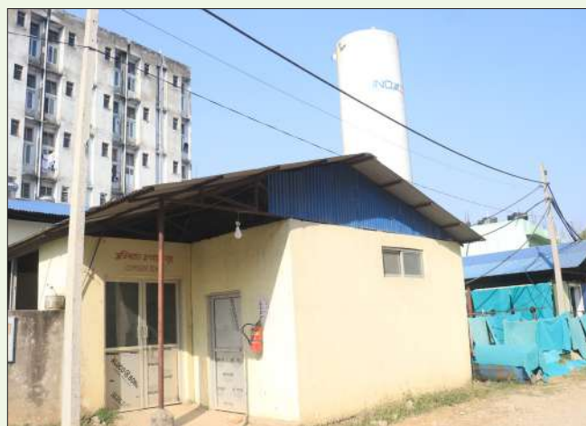
अस्पतालको आफ्नै अक्सिजन उत्पादन गृह (अक्सिजन प्लान्ट)
